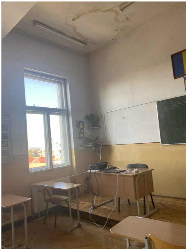
La ultimul nivel, atat la pereti, cat si la tavane, se prezinta degradari locale datorate infiltratiilor
