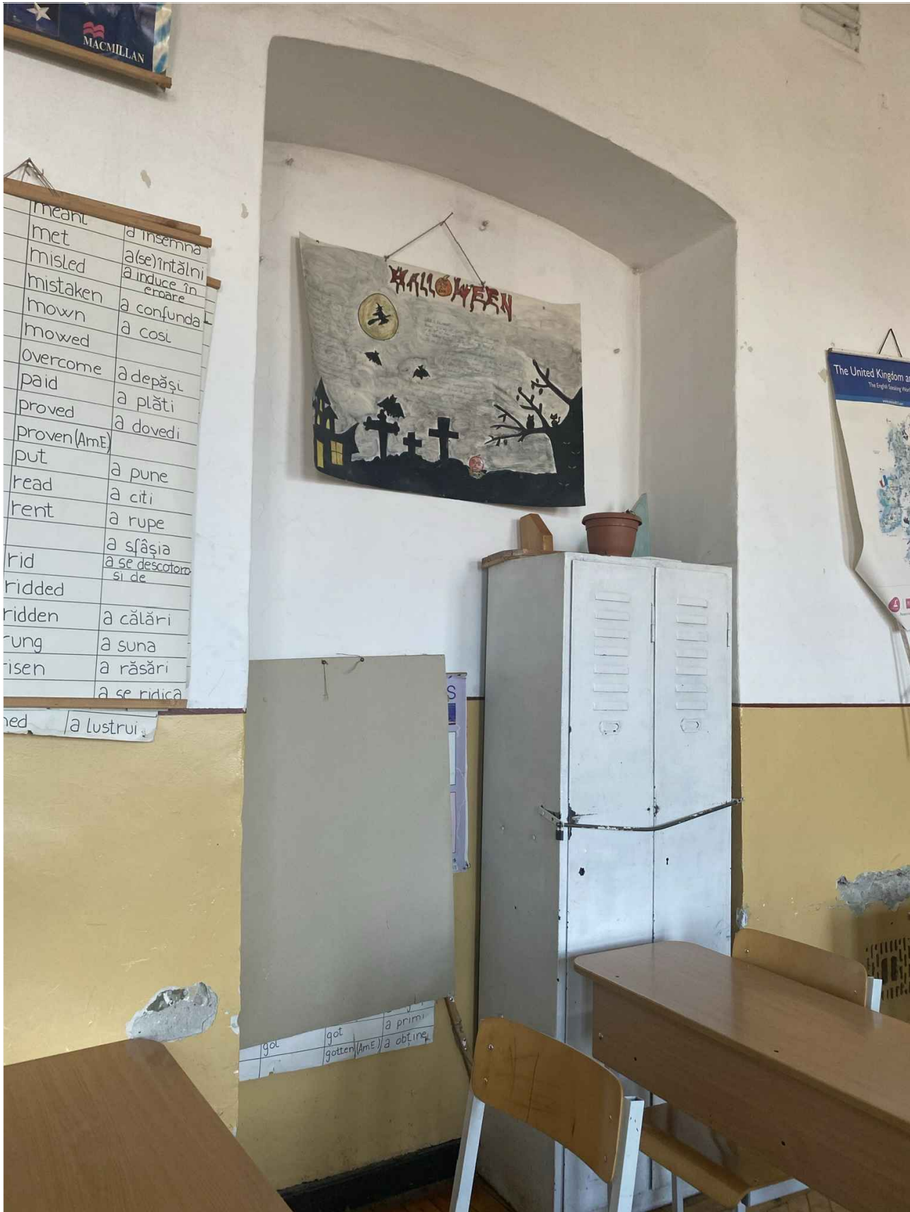
Tencuiala degradata sau desfacuta, in special la nivelul bancilor in salile de clasa.
